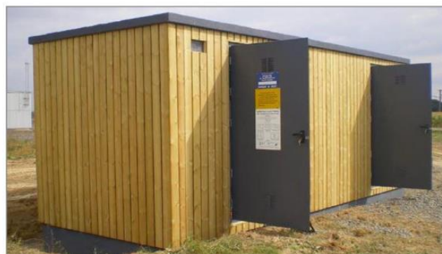
Figure 61 : Exemple d'un poste de livraison
