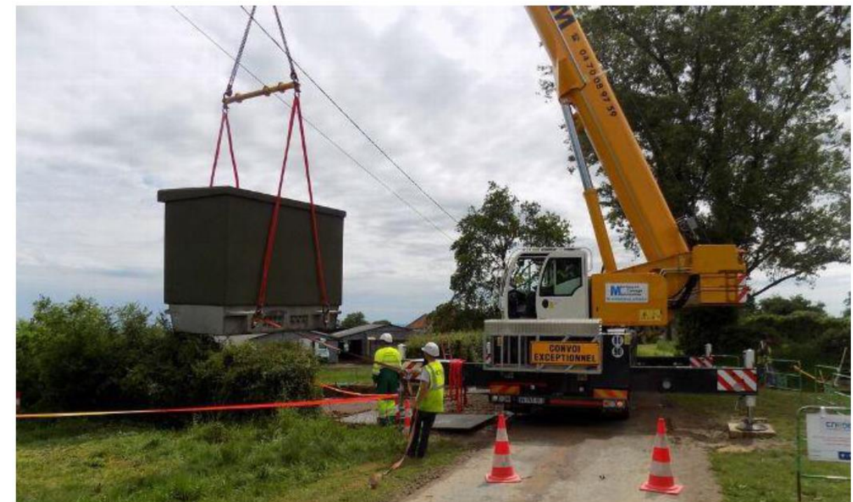
Figure 66 : Exemple d'installation d'un local technique dans le cadre de la mise en œuvre d'un projet photovoltaïque (Source : https://www.lamontagne.fr/verneix-03190/actualites/spectaculaire-operation-de-levage-au-village-d-effeloux_12415177/ )
