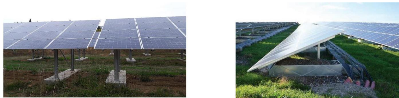
Figure 58 : Exemples de structures photovoltaïques avec les plots lestés bétons (gauche) ou gabions (droite) « zone 2 »
