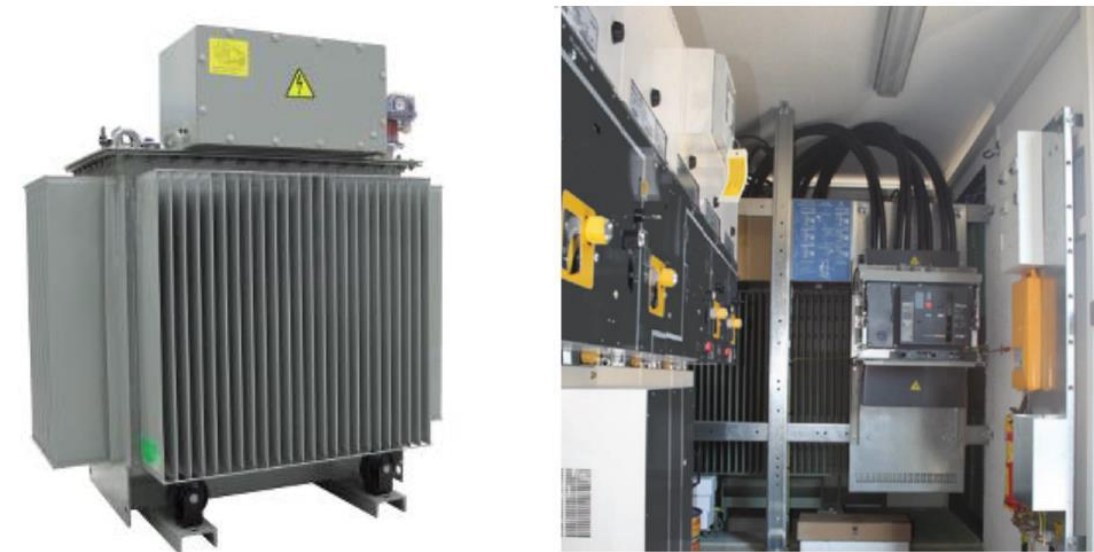
Figure 59 : Exemples de poste de transformation, photo d'un transformateur et de l'intérieur d'un poste
