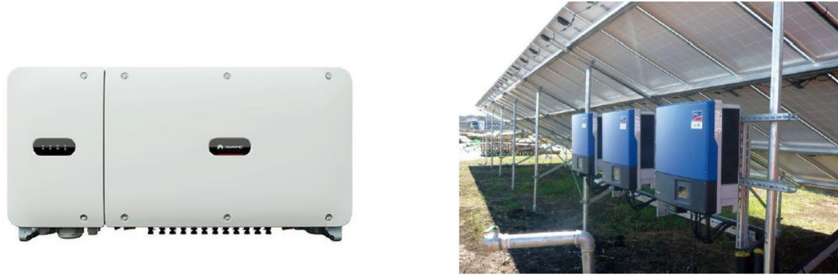
Figure 60 : Exemple d'onduleurs photovoltaïques et installation à l'arrière des structures
